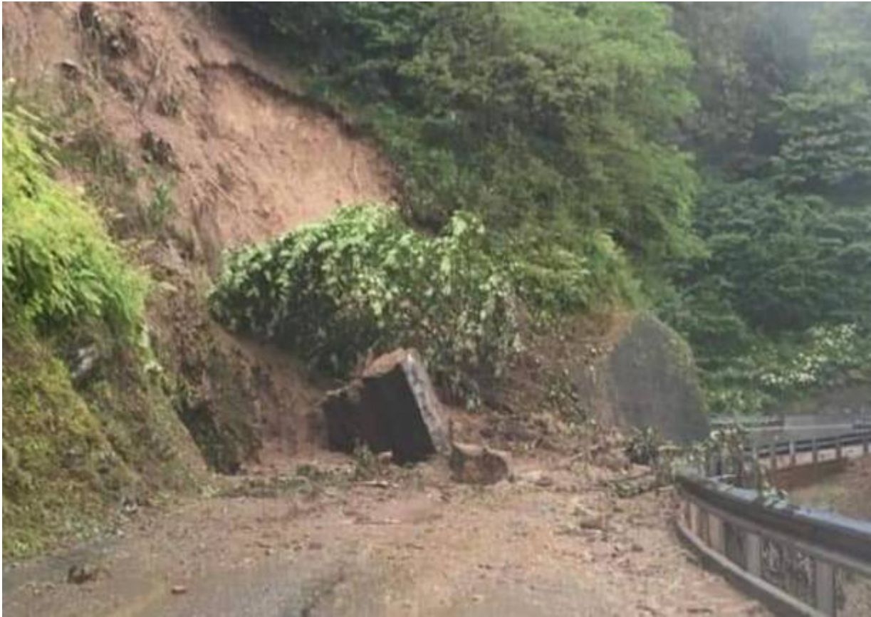
Frana sulla strada provinciale di Cremenaga in seguito a maltempo
